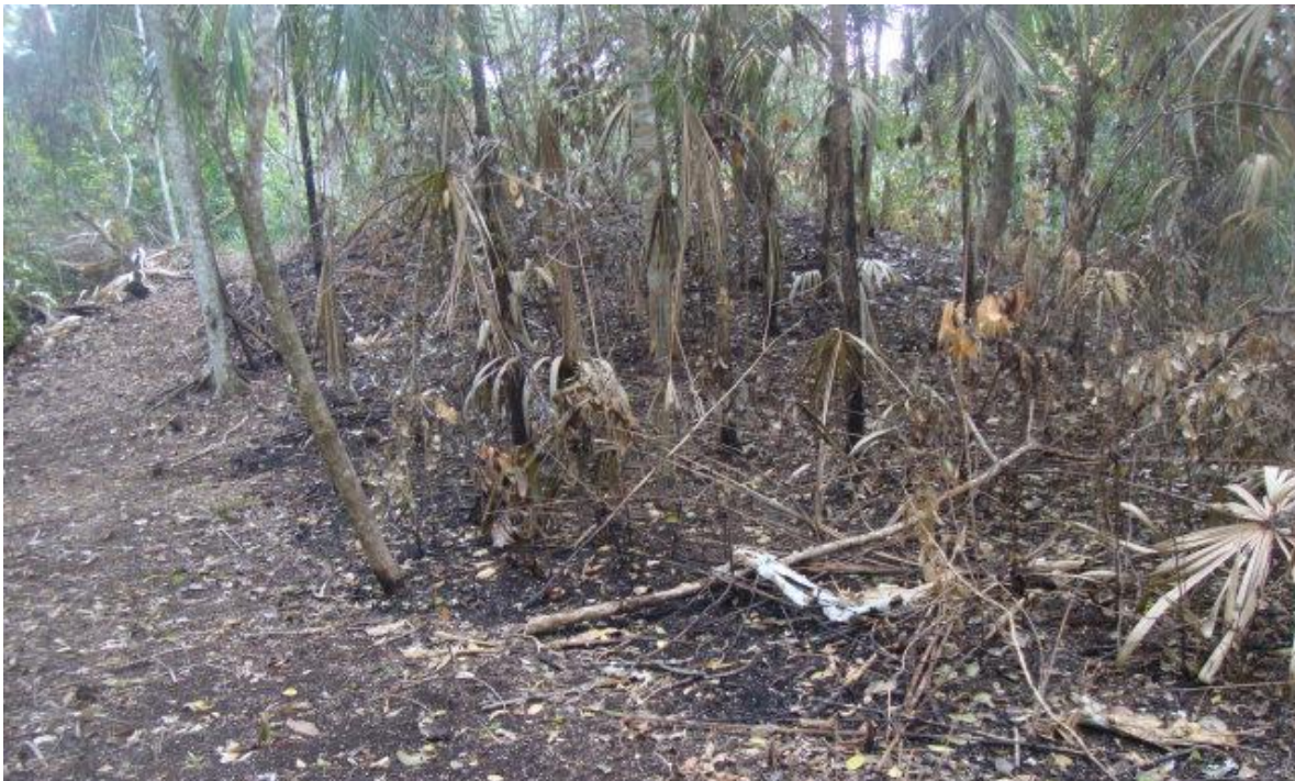
Figura 8.12. Estructura quemada en el lado oeste del Grupo F (Foto por J. Ponce)
