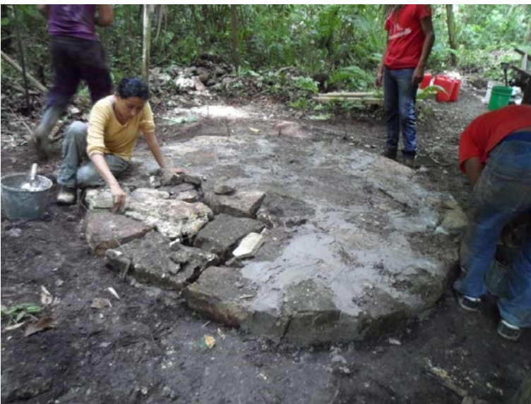
Figura 7.2 Construcción de plataformas de piedra, cal y tierra en Piedras Negras. 2015. Foto Juan Carlos Pérez
