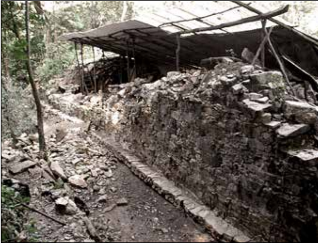
Figura 21. Fachada posterior del Templo XIX; la esquina suroeste del muro sur se encontró muy destruida. Archivo del Proyecto Grupo de las Cruces.
