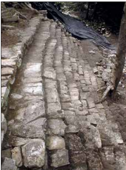
Figura 26. El proceso de restauración de la escalinata corrida en el primer cuerpo del basamento: (a) una vez libre de escombros; (b) una vez colocadas las lajas. Archivo del Proyecto Grupo de las Cruces.
