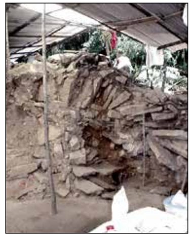
Figura 19. Fotografía de los muros colapsados. Archivo del Proyecto Grupo de las Cruces.
