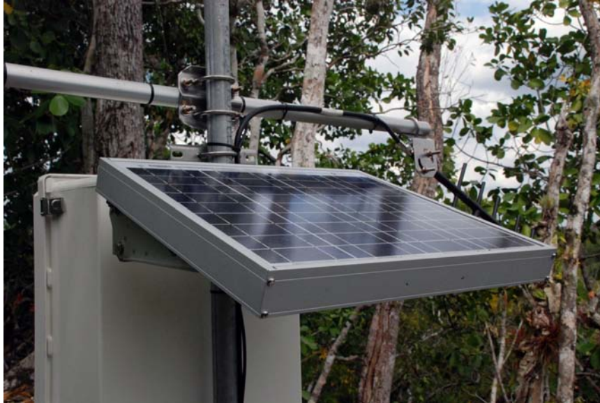
Fig.3.1.10. Panel solar, colocado en la antena 1. Foto L. Romero.
