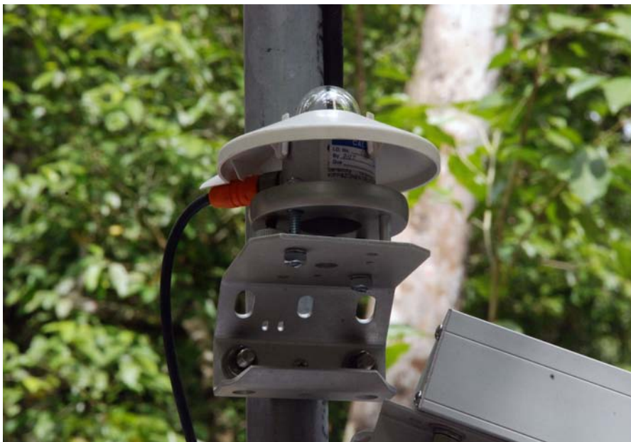
Fig.3.1.13. Sensor de luminosidad, colocado en la antena 2. Foto L. Romero
