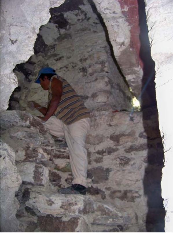
Fig.3.2.2. Relleno del área exterior de la esquina noroeste de sub-1 a . Foto A. Coronado
