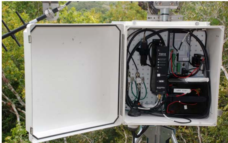
Fig.3.1.9. Hardware colocado en la antena 1. Foto L. Romero
