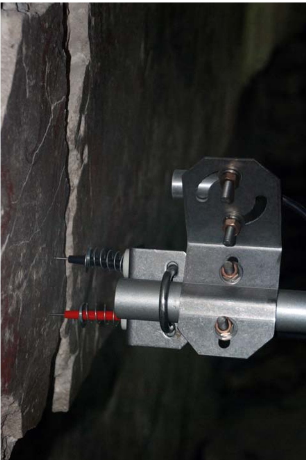
Fig.3.1.19. Sensor de movimiento y desplazamiento, colocado en el muro oeste dentro del cuarto de las pinturas. Foto L. Romero
