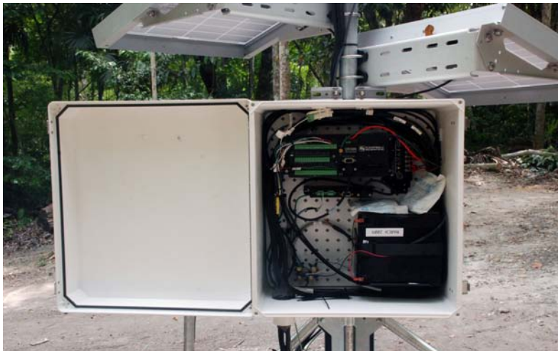
Fig.3.1. 8. Hardware colocado en la antena 2. Foto. L. Romero
