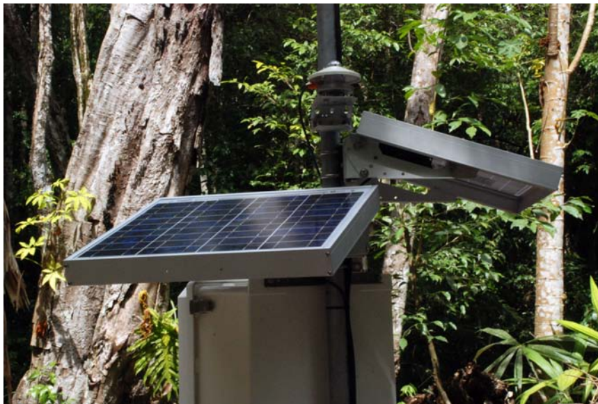
Fig.3.1.11. Paneles solares colocados en la antena 2. Foto L. Romero.
