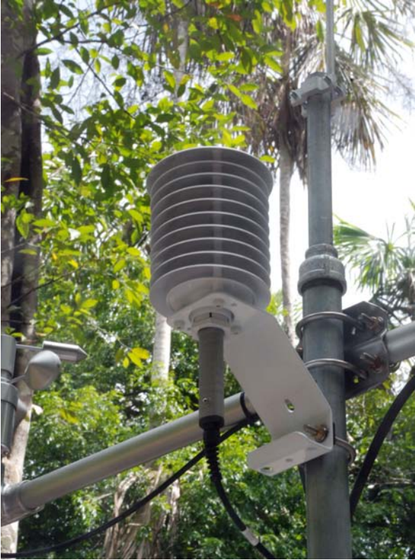
Fig.3.1.16, Sensor de Humedad exterior. Foto L. Romero
