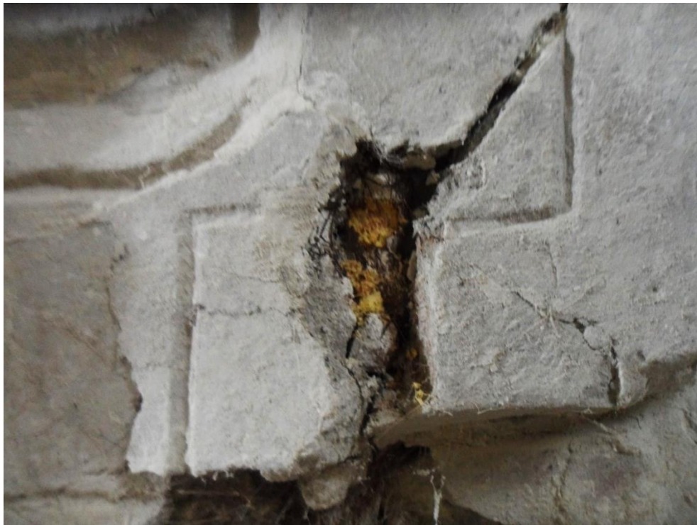
Figura 5.4. Ampliación de área de crecimiento de una raíz, se puede observar como al engrosar la raíz tiende a separar los estucos, estas raíces son eliminadas y tratadas con alcohol, pero el árbol sigue su crecimiento normal, por lo tanto, siempre están propensas a crecer y deteriorar los estucos.
