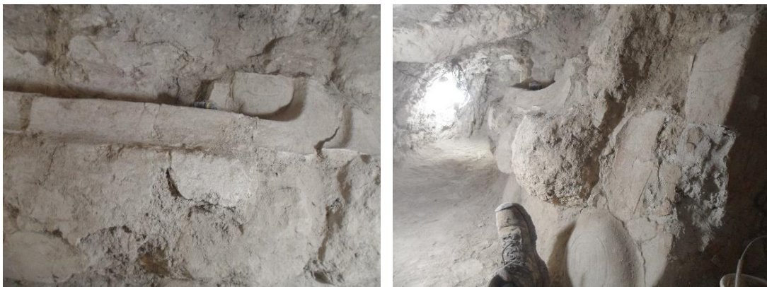
Figura 5.6 y 5.7. Áreas de riesgo del mascarón de la fachada Sur de la Estructura F8-7, en donde se observa los distintos estratos de construcción.
