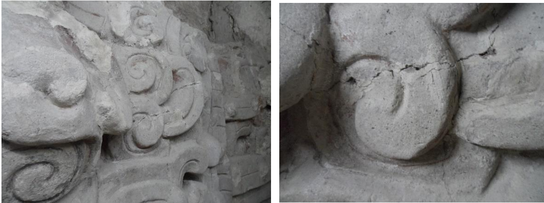
Figuras 5.2 y 5.3. Reactivación de fisura, derivado del crecimiento interno de raíz, el área de separación fue previamente tratada.
