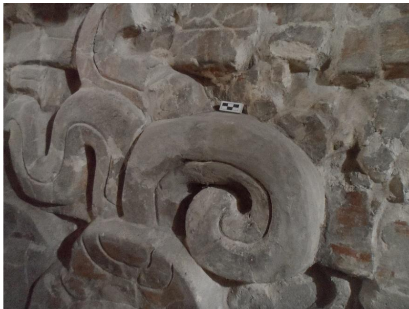
Figura 5.11. Área de voluta en donde se realizó una reposición estructural. Templo del Sol Nocturno (Foto E. Pérez 2019).
