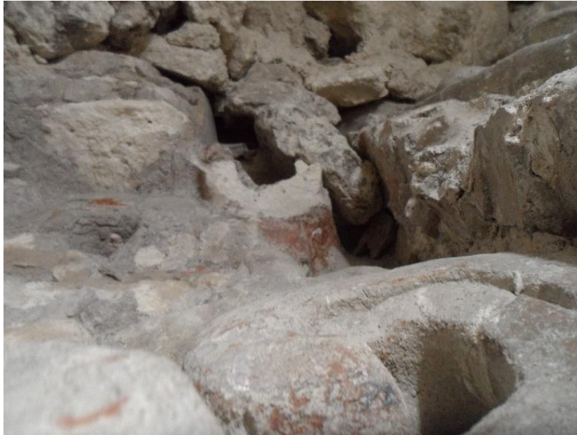
Figura 5.16. Canal de piedra tallada el cual estaba fracturado y fragmentado. Se encontro el fragmento y procedió a la colocacion del mismo.
