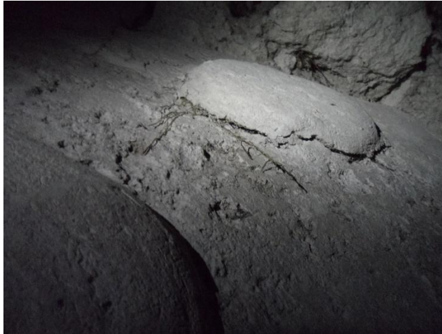
Figura 5.4. Aditamento del Mascarón 1 de la fachada noroeste de la Sub-estructura M7-1 en donde se observó la separación por las raíces en la parte posterior (Foto E. Pérez 2019).
