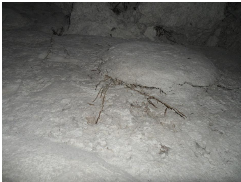
Figura 5.27. En la fotografía se observan raíces que brotan de la fisura de un elemento en la parte superior del mascarón, el crecimiento de esta raíz provocó las fisuras y el debilitamiento del elemento adherido por medio de la técnica de pastillaje. Foto Edwin Pérez 2019.
