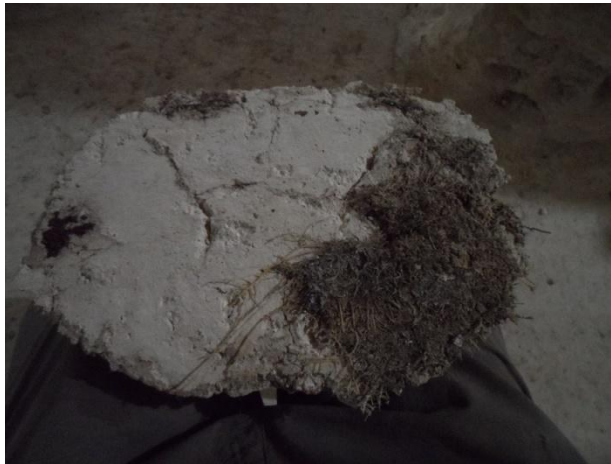
Figura 5.5. Parte posterior del aditamento en donde se observan las raíces que provocaron la separación, Estructura M7-1. (Foto E. Pérez 2019).
