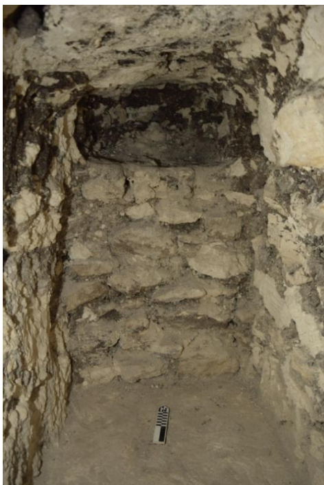
Figura 1.9. Muro de contención que corre de Este a Oeste, Estructura M7-2. (Foto: Rony Piedrasanta).
