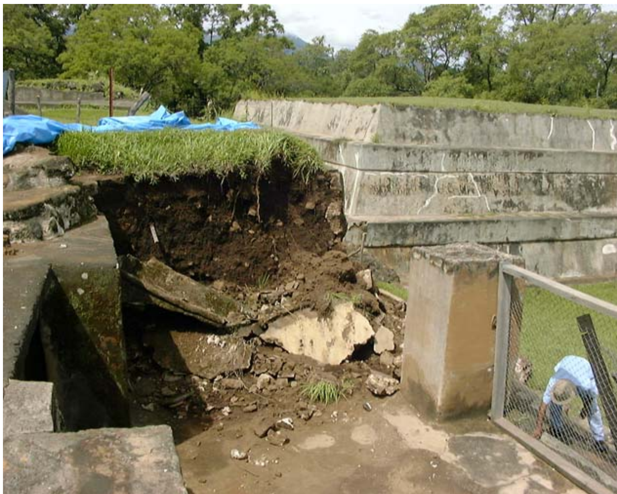
Figura 12 Colapso del Edificio de las Columnas en 2002
