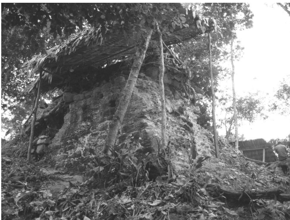
Figura 9 Sección del muro norte que requiere intervención inmediata (Fotografía P. Morales 2009).
